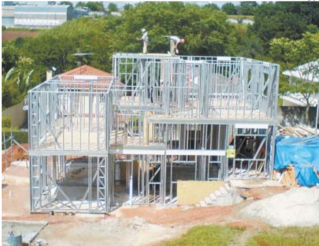
Obra com steel frame, estrutura metálica de aço leve, totalmente reciclável, que permite a escolha do acabamento
